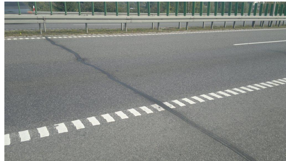
Spękanie niezabezpieczone masą zalewową
