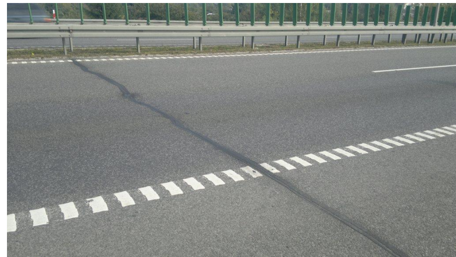
Spękanie niezabezpieczone masą zalewową
